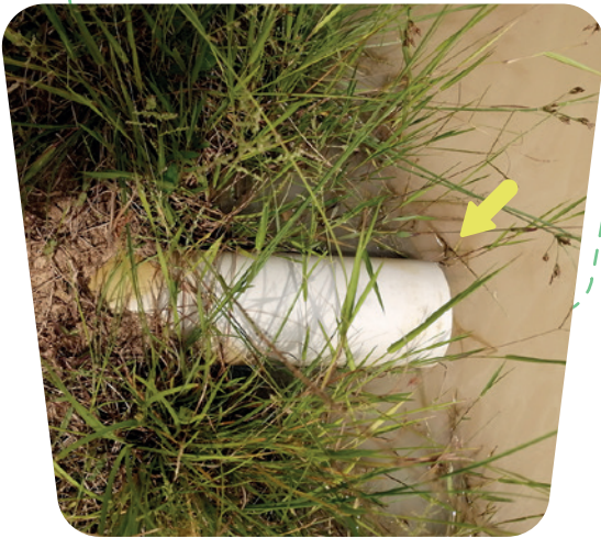
Control de rebosamiento de un estanque piscícola sin protección, en el municipio de Arauca
