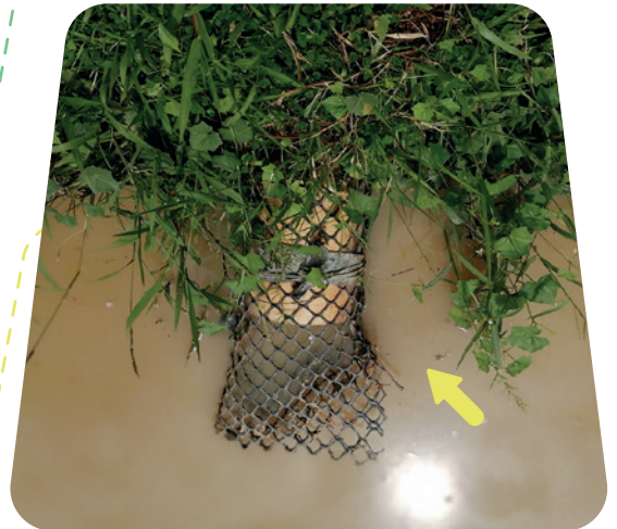
Control de desagüe de un estanque piscícola con protección, en el municipio de Arauca
