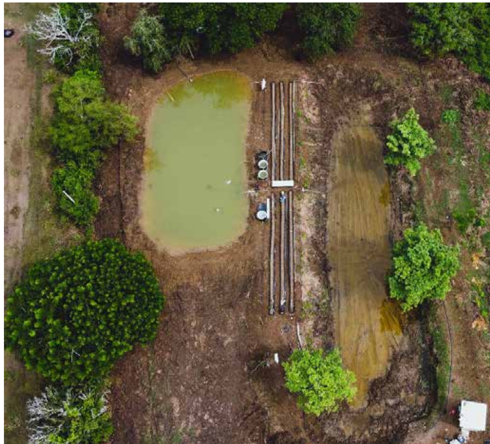
Vista superior del predio Los Ciruelos, obras de mejoras al sistema de recirculación acuapónico comunitario en Repelón, Atlántico.
