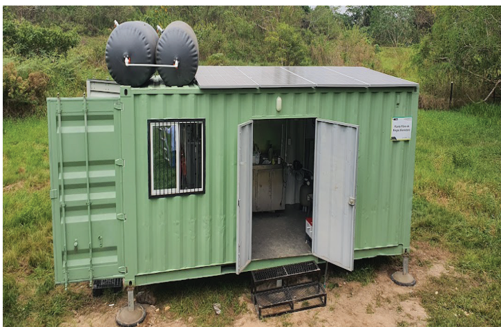
Figura 18. Planta piloto móvil de biogás/biometano, instalada en el campus de la sede Orinoquía
