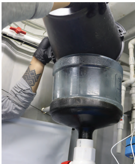
Figura 22. Alimentación del reactor principal de la planta piloto de biogás/biometano
