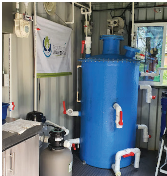
Figura 20. Reactor metanogénico de la planta piloto instalada en Arauca Fuente: elaboración propia.
